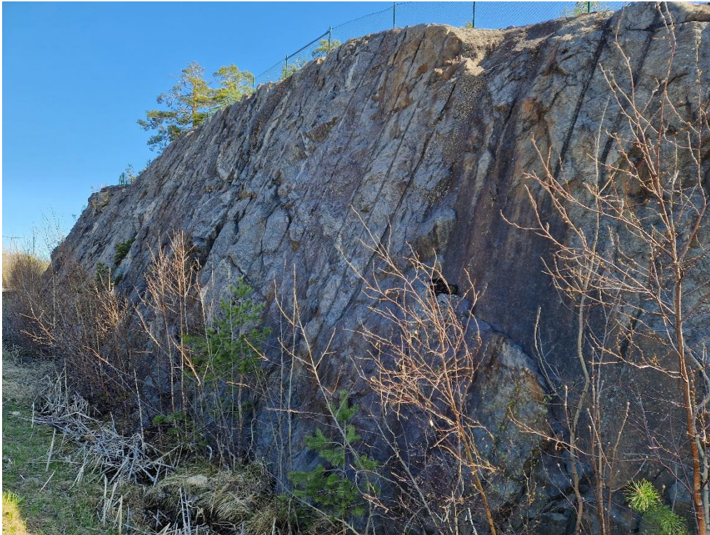
Figur 6. Berghäll 1 åt söder vid Ormingeleden. Brant lutning bedöms vara 5:1 samt tidigare sprängd. Bergmassan har varit sprängd tidigare och relativ sprickfattig samt övervägande homogent. Bergmassan var lätt vittrad och bedöms vara stabil.
